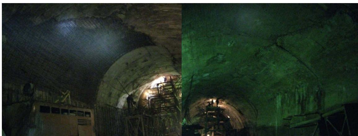
Рисунок 4-6: СТ2, слева зона вывала, после участка затворов; справа трещины в своде на участке между затворами и зоной вывала
