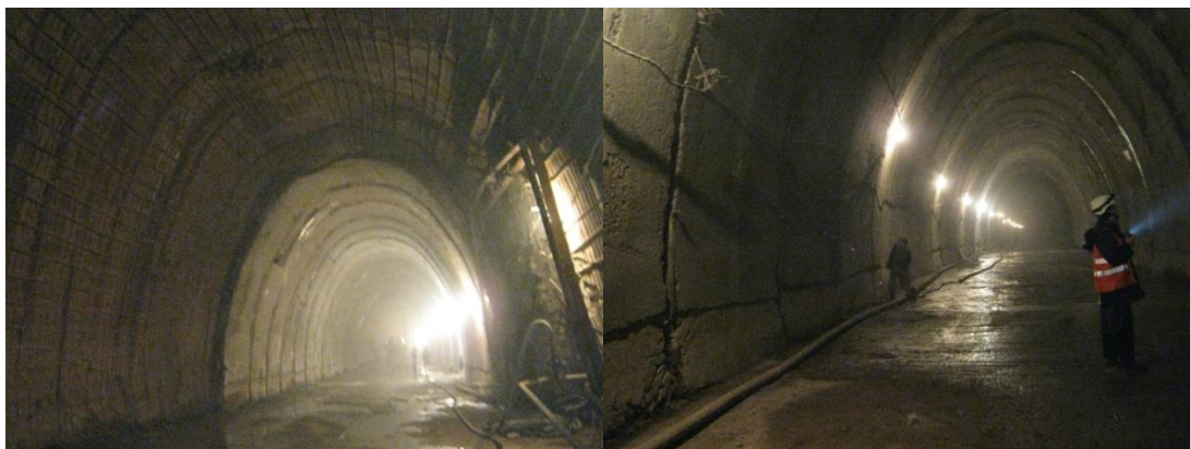
Рисунок 4-4 : Кабельные галереи, вид со стороны трансформаторного помещения
