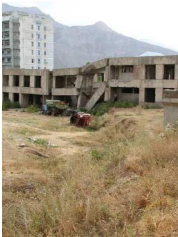
Рисунок 45. Проседание поверхности наносит ущерб зданиям.
